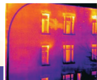
Détection d'eau mur de briques
